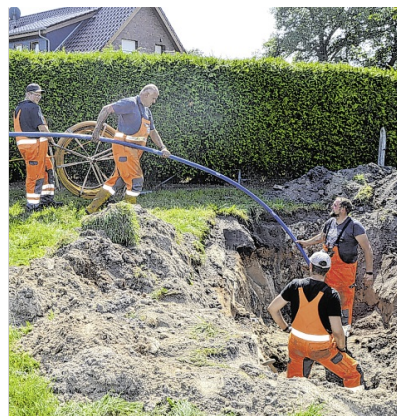
In Burlage gab es am Freitagabend und am Montag an der Landesstraße 30 in Richtung Bockhorst zwei Wasserrohrbrüche. FOTO: WEERS
